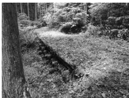
既設作業道の木製土留工腐朽状況
